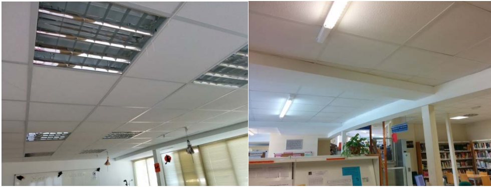
Imagen 7. Luminarias instaladas en el centro
