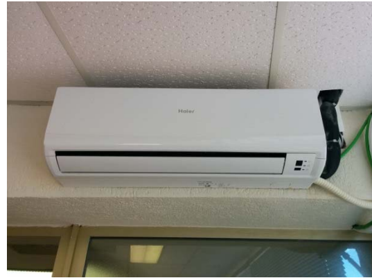
Imagen 12. Unidad interior tipo Split de pared
